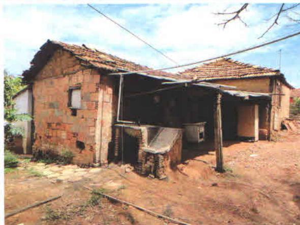
Foto 2: Residência de João Domingos. Vista geral posterior. Data: novembro/2010. Foto: Iara Camacho
